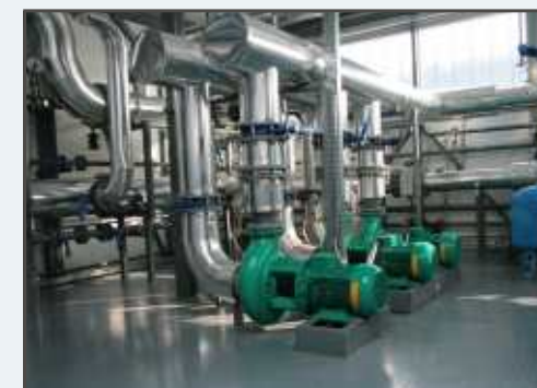
ОВК и водоснабжение
